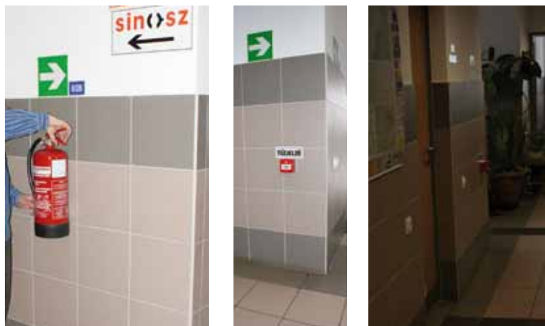
14a-c. kép „A” épület tűzoltó készülék, tűzjelző
