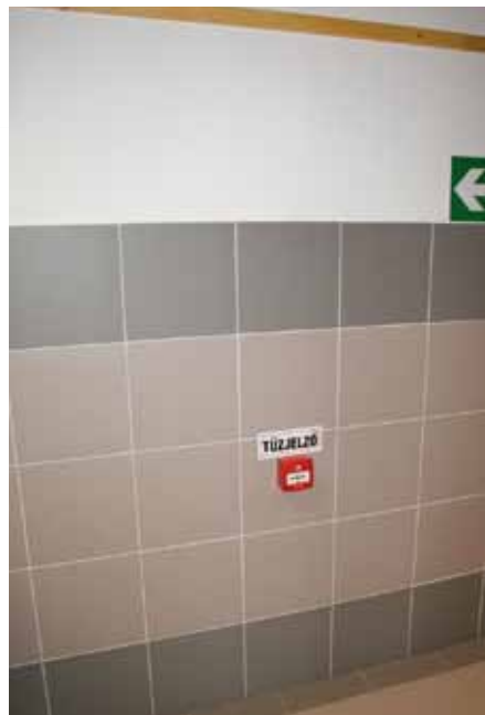
21. kép: „A” épület tűzjelző
